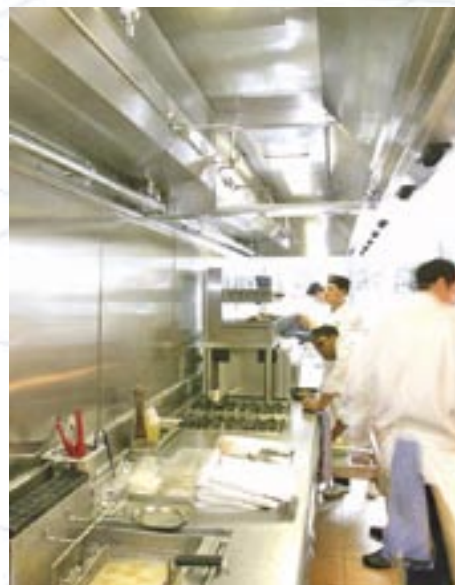
Hottes à lavage automatique, Marriott International, Grande Bretagne
